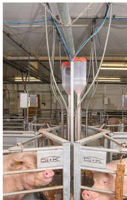
▷ Die blauen Tränkeleitungen verlaufen entlang der Stalldecke. Leerrohre erleichtern die Reinigung.
